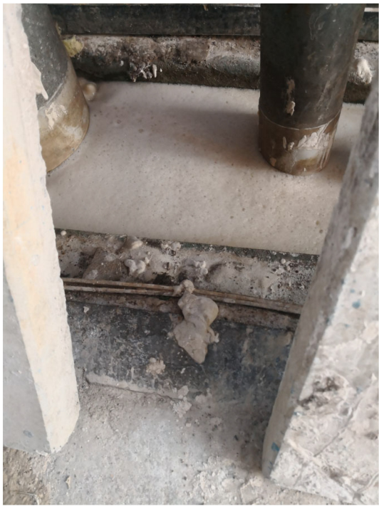
图 2 脱硫塔浆液起泡溢流到地沟情形
