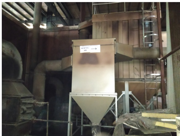
图 1 除尘装置现状
