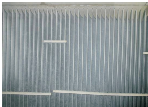
图 1 屋脊除雾器第二级上部
